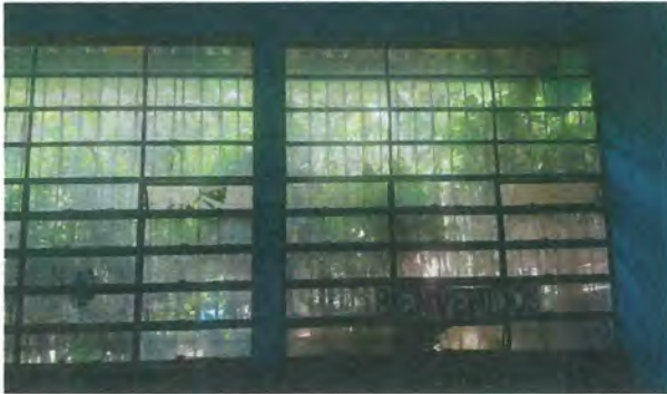
Foto 1: La estructura de metal de ventana se encuentra deteriorada al igual que los vidrios se encuentran dañados.
