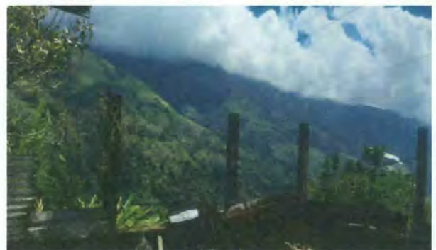
Foto 4: Mantenimiento del muro perimetral que amerita sustitución de los componentes por encontrarse en mal estado y deteriorada.
