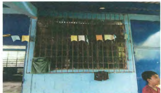
Foto 2: Los balcones de metal se encuentran oxidados que ameritan trabajos de mantenimiento en su estructura.
